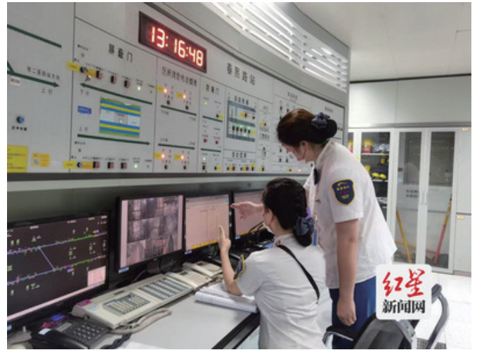
图1: 地铁施工运行监控中心实时调度与安全 管理场景
